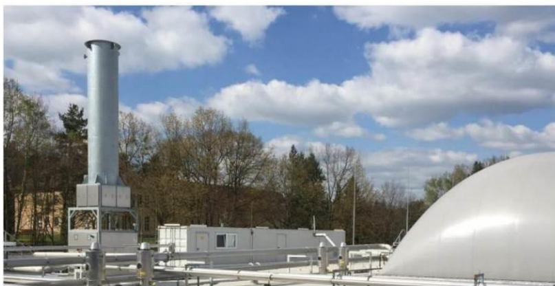
3.attēls Fermentatora jumts ar tehniskajiem konteineriem, gāzes uzkrāšanas tvertni un uzliesmotāju
